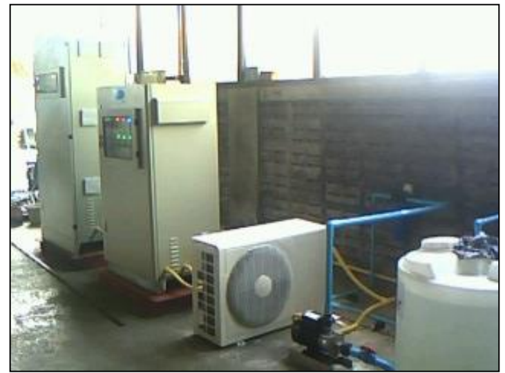
ระบบโอโซนบำบัดกลิ่นกระบวนการอบยาง
