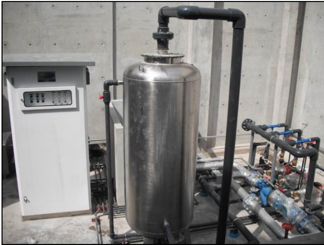
• บำบัดน้ำ Cooling Tower “ร.พ.ศิริราช”
