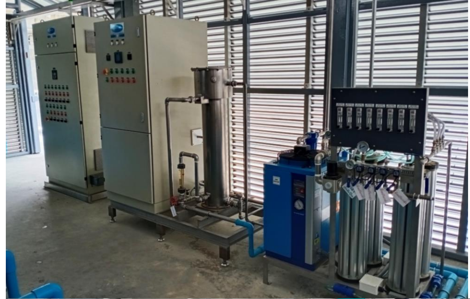
ไอโซนบำบัดน้ำ Cooling Tower สถานีรถไฟบางซื่อ
