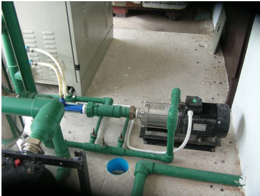
รูปที่ 5 แสดงการติดตั้งของเครื่องผลิตโอโซนและอุปกรณ์ประกอบต่าง ๆ
